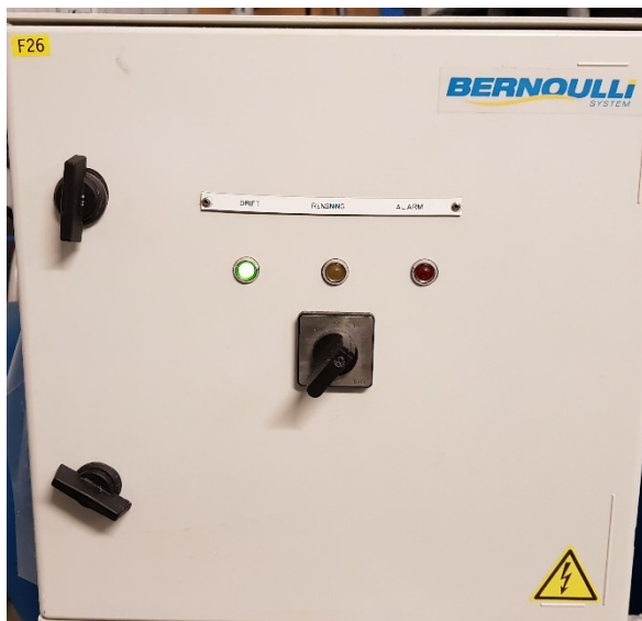
Bilde 2: Betjeningspanel Bernoulli-filter skal være grønt
